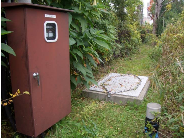
1. ポンプ操作盤（芦ヶ池入り口付近）
